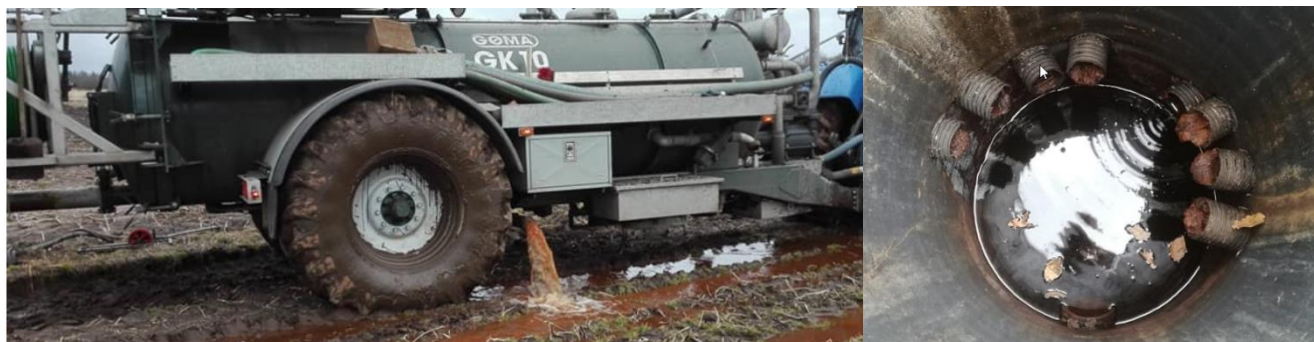
Figur 4: Opumpning af drænsplulevand til terræn (t.v.) og samlebrønd (t.h.).
